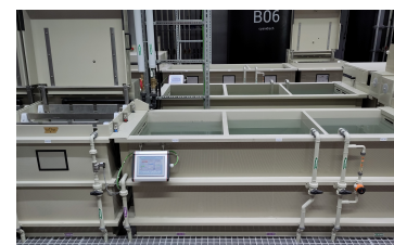
Abbildung 2: Galvanische Einheit mit umfangreicher Sensorik, chemisch komplexem Verhalten und Speicher programmierbarer Steuerung (SPS)
